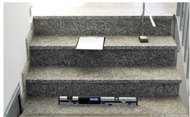
Die erforderliche Antrittshöhe wird augenscheinlich nicht erreicht.
